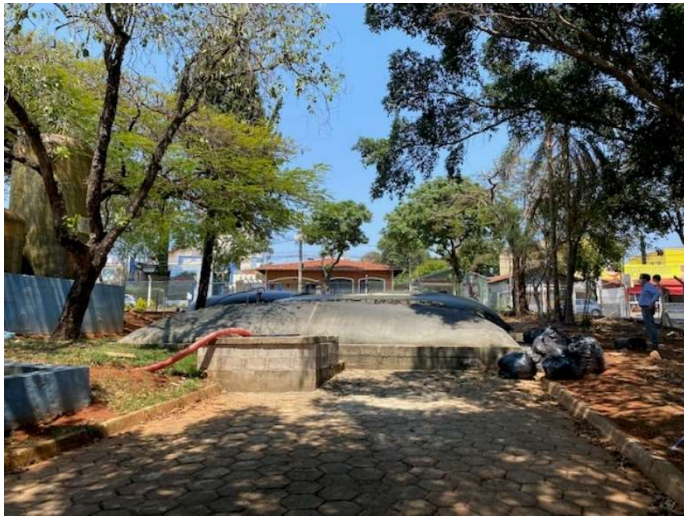
Tratamento de Lodo da ETA I – Não Conformidade do CAC
