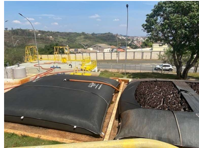
Tratamento de Lodo da ETA II – Não Conformidade do CAC
