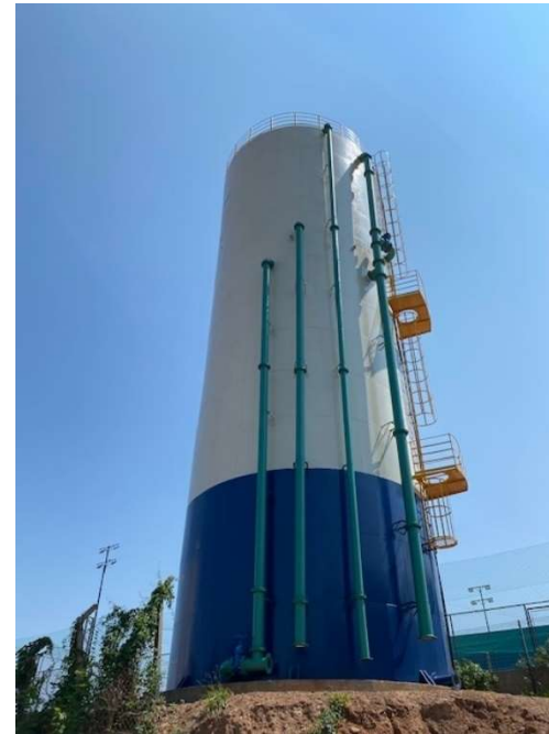
Reservatório Santo Antônio (600 m 3 ) – Não Interligado
