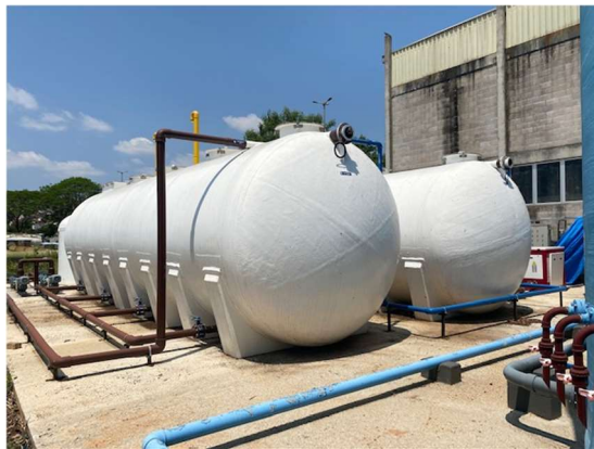
ETE Compacta de Nível Secundário - Módulo de 450m 3 /dia
