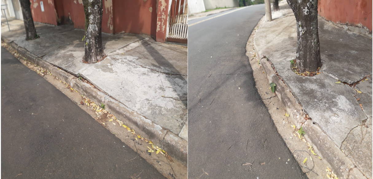
Calçada levantada e deformada, ocasionando perigo aos pedestres.
