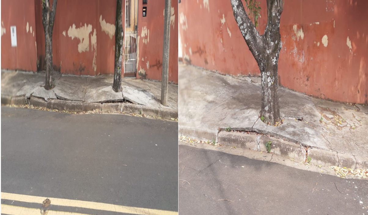
Sarjeta e calçada deformadas, decorrente das raízes das árvores.
