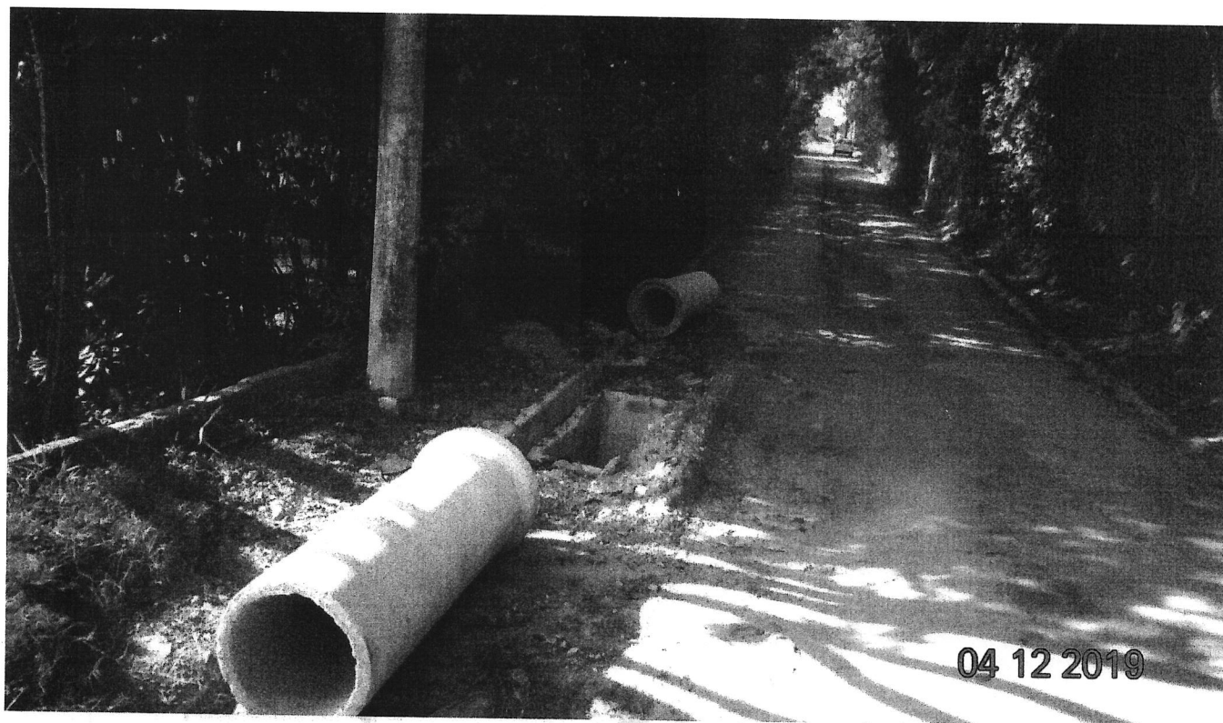
Foto 01 - Rua Itatiaia (Data - 12/04/2019)
