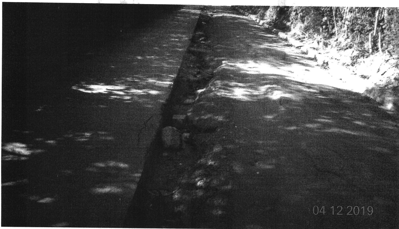
Foto 02 - Rua Itatiaia (Data - 12/04/2019)
