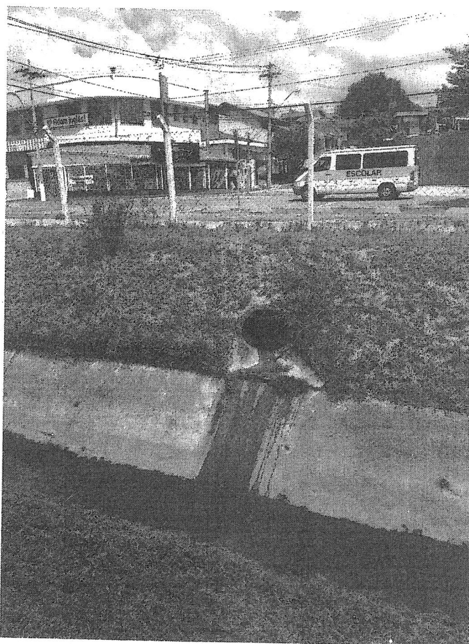
Foto 01 – tubulação de captação de águas pluviais localizada no CLT, da qual houve lançamento de efluente (Foto tirada às 12:06).
