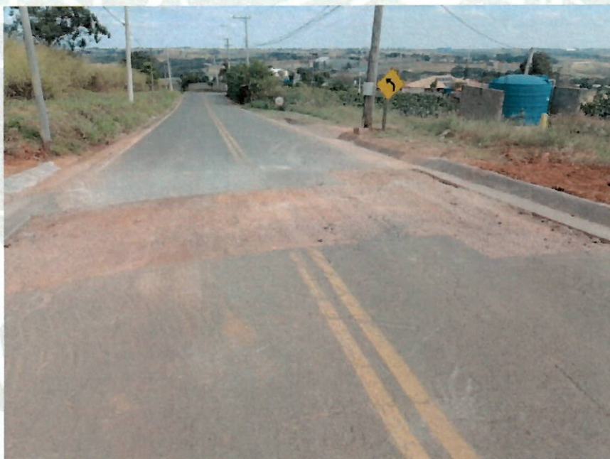
4- Trecho onde falta recapeamento - Vistoria em 19/07/2023
