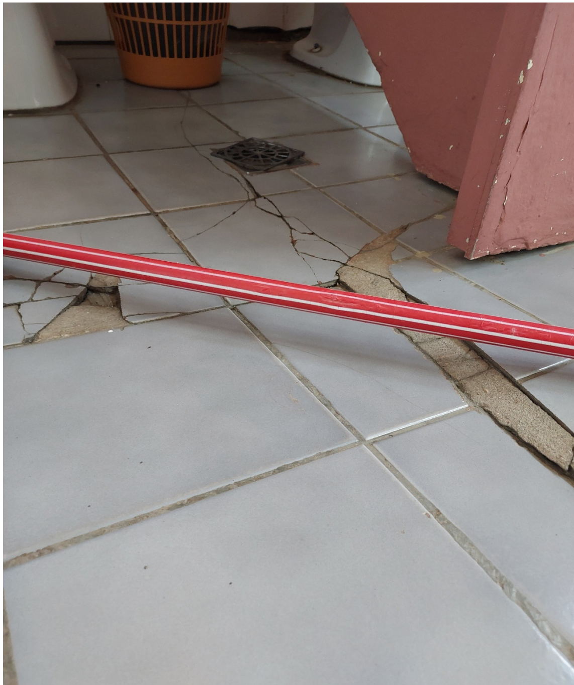
Piso cedeu e quebrou o revestimento.
