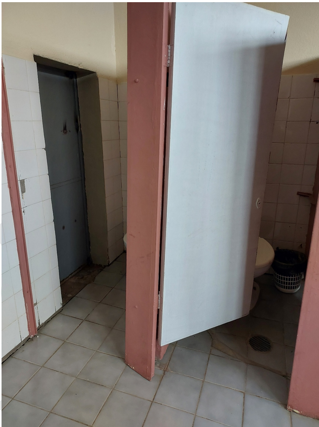
Divisória quebrada e solta – pode cair.
