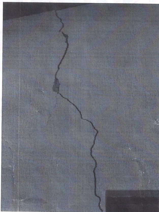
Foto entrada da edificação, preocupante.
