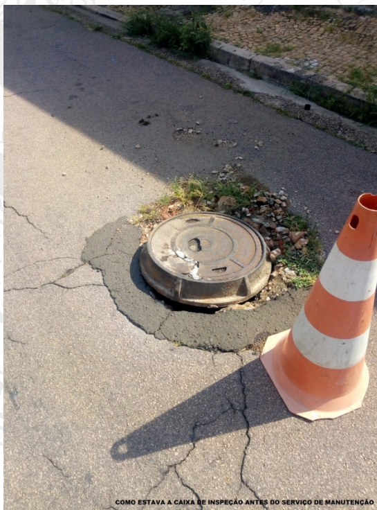
Caixa de inspeção antes da manutenção
