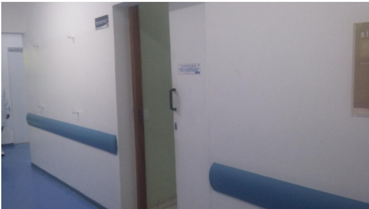
Pintura do corredor de circulação 5, já com a Barra Impermeável, reforma da Porta do Raio – X e cantoneiras instaladas, – Térreo
